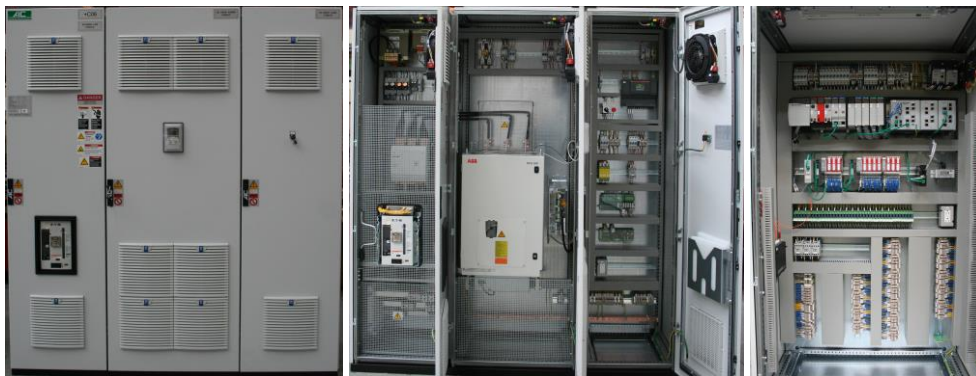
Drive DC e quadro di Automazione forniti da AIC a GERDAU
